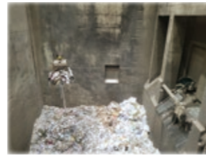
ごみをためておくピットとクレーン
